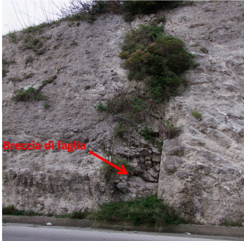
Faglia in corrispondenza della trincea stradale al Km 22+600 della SP 14 – Mare Monti
